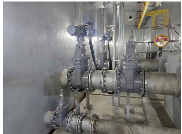
손상내용 유출밸브실 유출조절밸브 상태양호 손상원인 -
