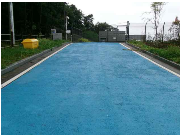
위 치 송수관로 Sta.3+16.1 손상내용 포장 상태양호
