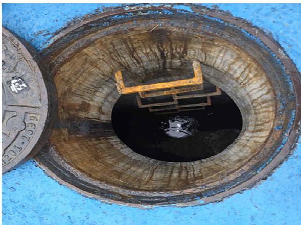
위 치 송수관로 Sta.3+16.1(점검구) 손상내용 점검사다리 상태양호
