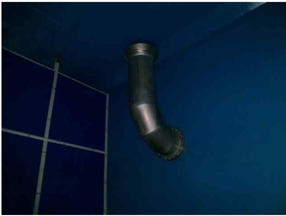
손상내용 1지 유입배관 상태양호 손상원인 -
