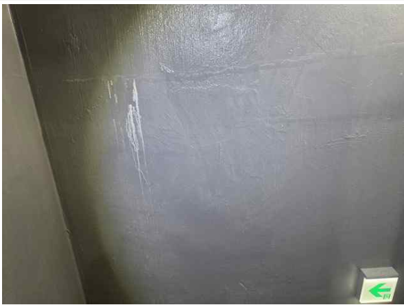
손상내용 계단실 내부 벽체 백태 손상원인 습윤흡착
