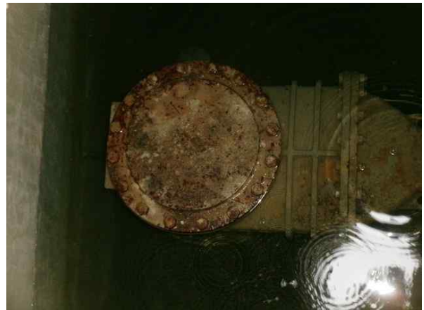
위 치 송수관로 Sta.3+16.1(점검구) 손상내용 점부식
