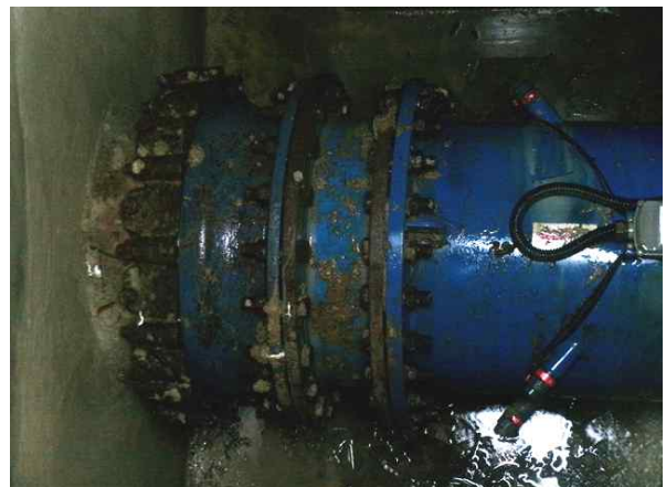
위 치 송수관로 Sta.4+0.0(유량계실) 손상내용 볼트 부식
