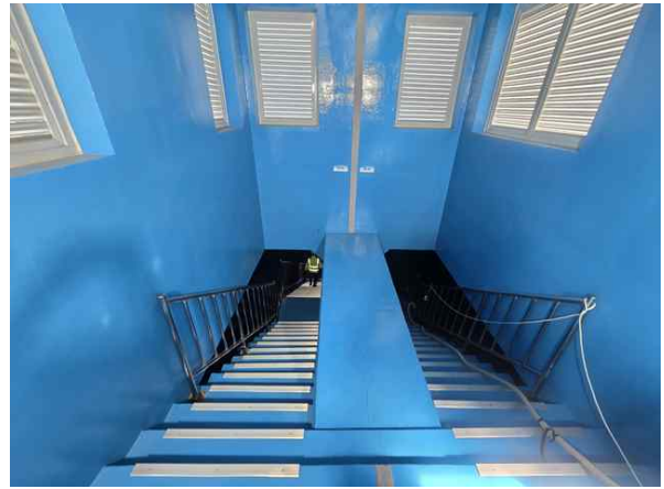
손상내용 검수실 내부 상태양호 손상원인 -
