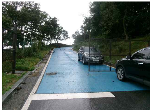
위 치 송수관로 Sta.17+1.5 손상내용 포장 상태양호
