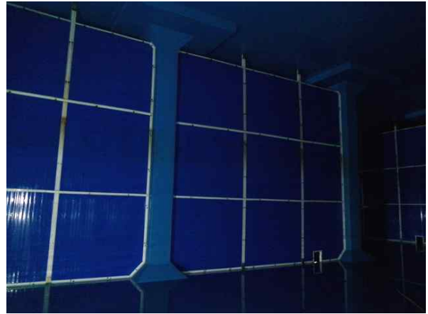
손상내용 2지 도류벽 상태양호 손상원인 -
