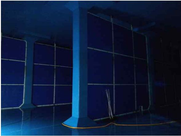
손상내용 2지 기둥 상태양호 손상원인 -
