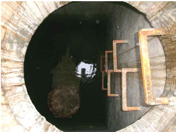
위 치 송수관로 Sta.3+16.1(점검구) 손상내용 밸브실 체수(H=0.3m)
