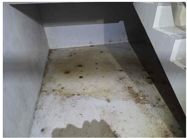
손상내용 계단실 내부 바닥슬래브 체수흔적 손상원인 외부 우수유입
