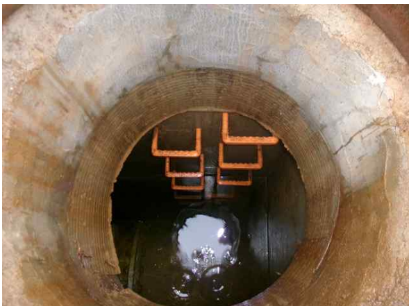
위 치 송수관로 Sta.17+1.5(점검구) 손상내용 침수(H=1.5m)
