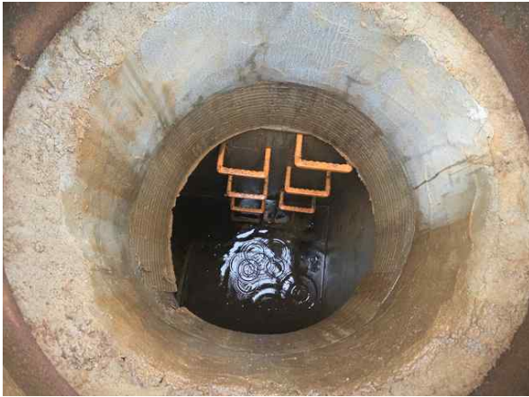
위 치 송수관로 점검구(B1-2) 손상내용 사다리 설치 상태양호
