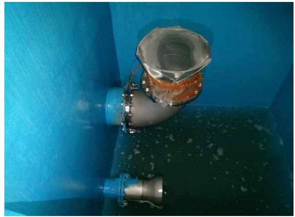
손상내용 2지 유출배관 상태양호 손상원인 -
