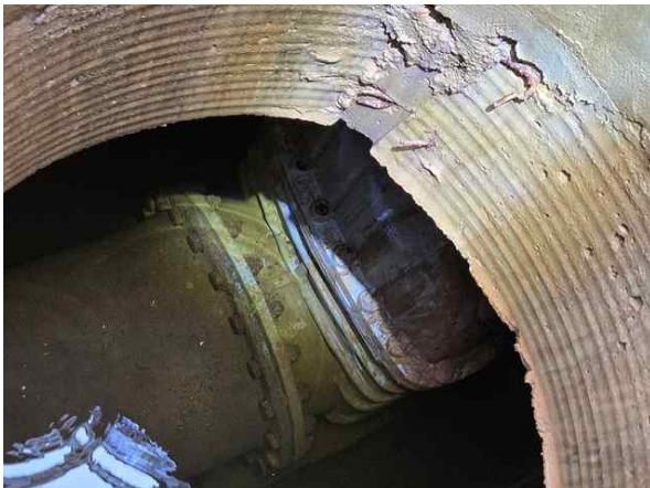
위 치 송수관로 Sta.17+1.5(점검구) 손상내용 볼트 부식
