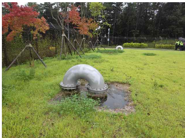
손상내용 환기구 상태양호
