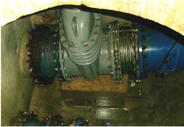
위 치 송수관로 Sta.4+0.0(유량계실) 손상내용 유입신축관 볼트 부식
