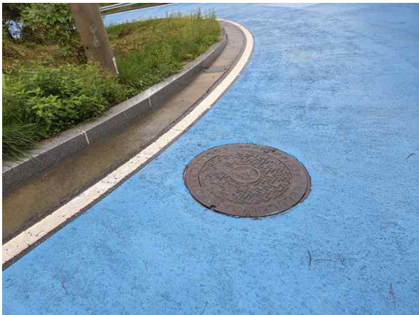
위 치 송수관로 유량계실 손상내용 맨홀 덮개 상태양호
